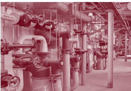
Паровые трубы ЮГ-Энергосервис. Компания обеспечивает теплом 12 500 жителей.
