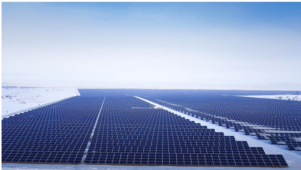
Elektrownia fotowoltaiczna na dużą skalę – 100 MWp (źródło: Goldbeck Solar)
