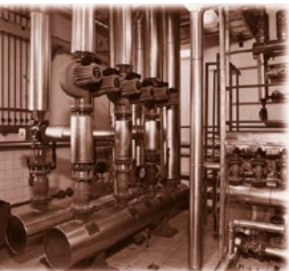
Энергосервисная компания "Прометей", Венгрия
